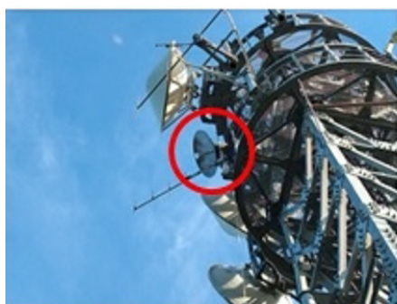
・アンテナ設置写真(離島側)
